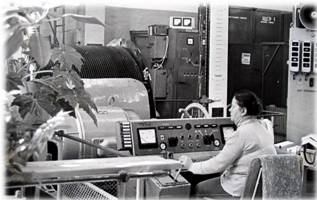
Пульт управления шахтными лебёдками на ГОКе «Ковдорслюда»
