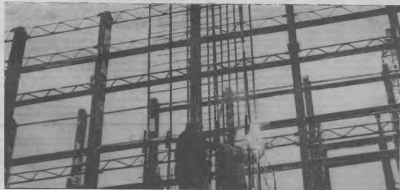
На снимке: момент сварки металлических колонн в электропролете корпуса обогащения апатито-бадделеевой фабрики. Фото Ю. Петрухина.
