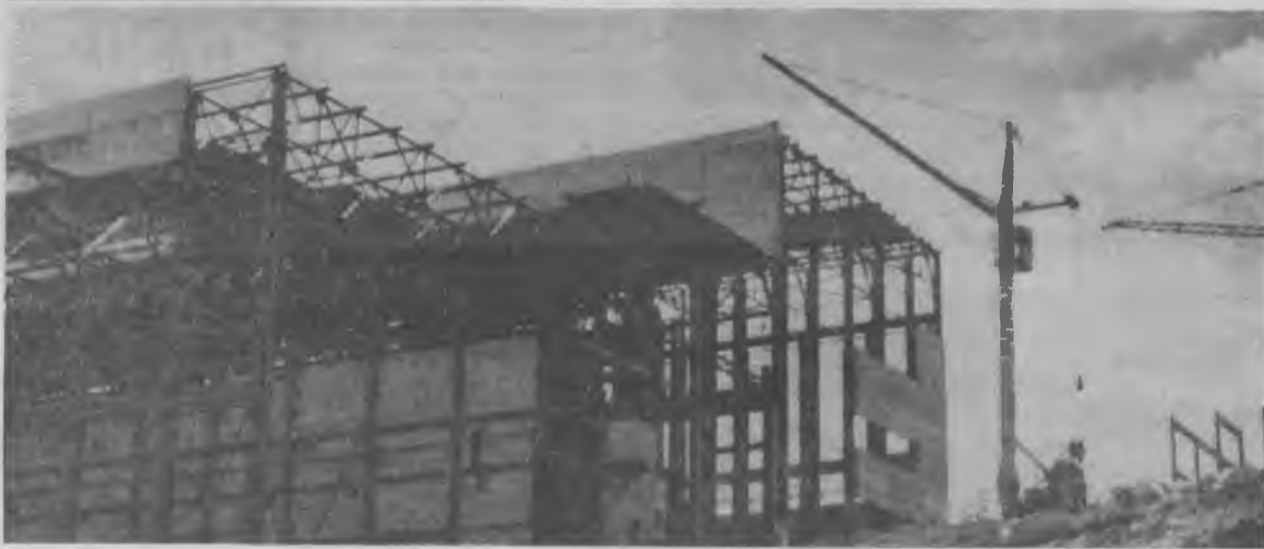
Корпус обогащения. Участку «Севзапстальконструкции» осталось закончить монтаж металлических покрытий пролетов «А» — «Б» и «Е» — «Д». Бригада П. Корнюха бетонирует 3-е монолитное перекрытие и монтирует стены третьего этажа энергопролета. Комсомольско-молодежная бригада А. Дробота в пролетах «А» — «Б» и «Б» — «В» навешивает стеновые панели. На снимке: Пролеты от ряда «А» (справа) до ряда «Е».
