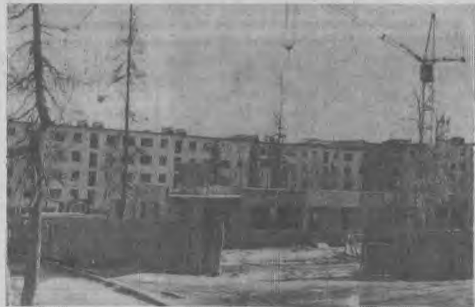
Начато строительство детского садика на 140 мест по улице Зеленой для детей работников треста «Ковдорстрой».
